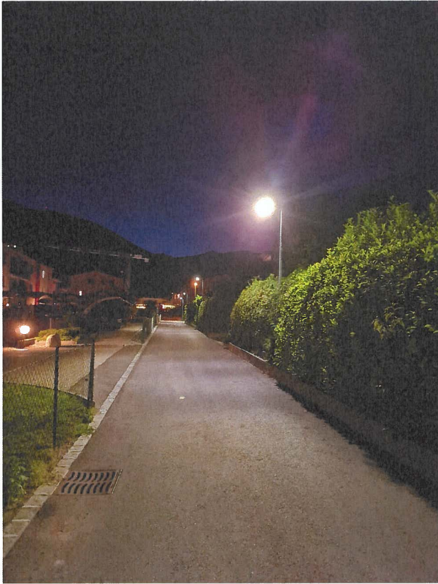
Via Monda – pali bassi – lampada nuova
