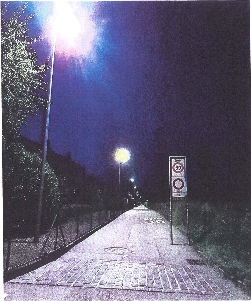
Via Baragia – pali alti – lampada nuova
