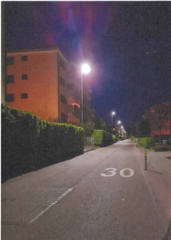
Via Rompada – pali alti – lampada vecchia con lampadina LED
