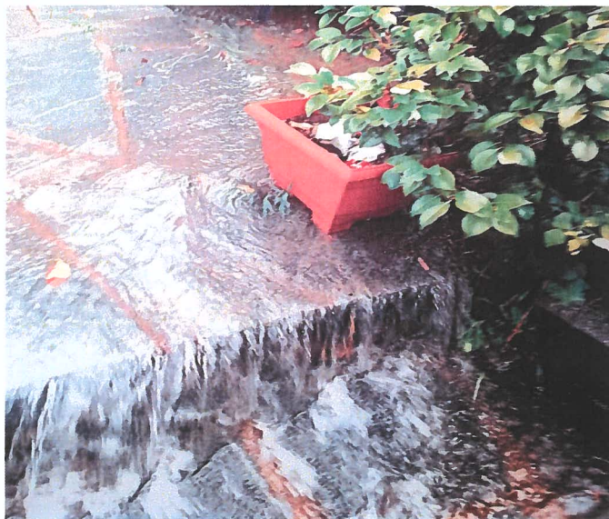
Foto 2: Acqua che scorre lungo la scala di accesso ai mappali privati.
