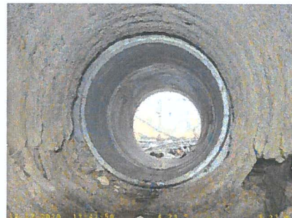
TreMa 38 - Griglia_0003.jpeg, 00:00:25, 2.27m Danno superficiale: parete mancante, causa non individuabile esattamente, a ore 5
