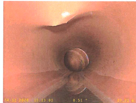
M3_1 - M4_1_0006.jpeg, 00:05:12, 37.72m Deformazione della sezione tubo: a ore 11
