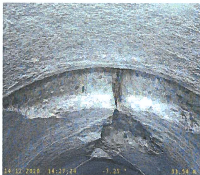
TreMa39 - M2_1_0009.jpeg, 00:06:41, 33.54m Danno superficiale: parete mancante, causa non individuabile esattamente, a ore 12
