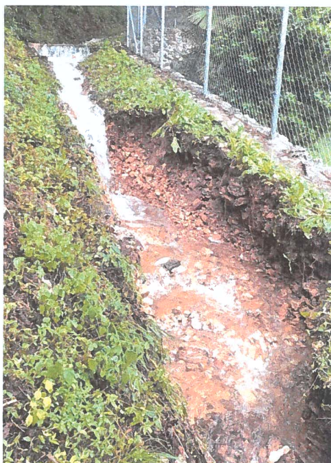
Figura 6: Sentiero a monte di Via Sassalto eroso dalle acque a seguito delle importanti precipitazioni del 7.6.2020
