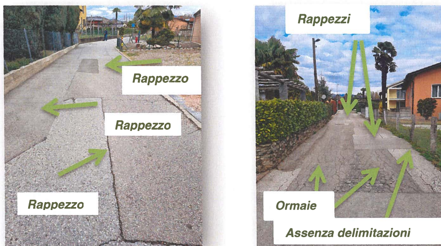
Figure 3 e 4: individuazione rappezzii, ormaie e assenza di delimitazioni
