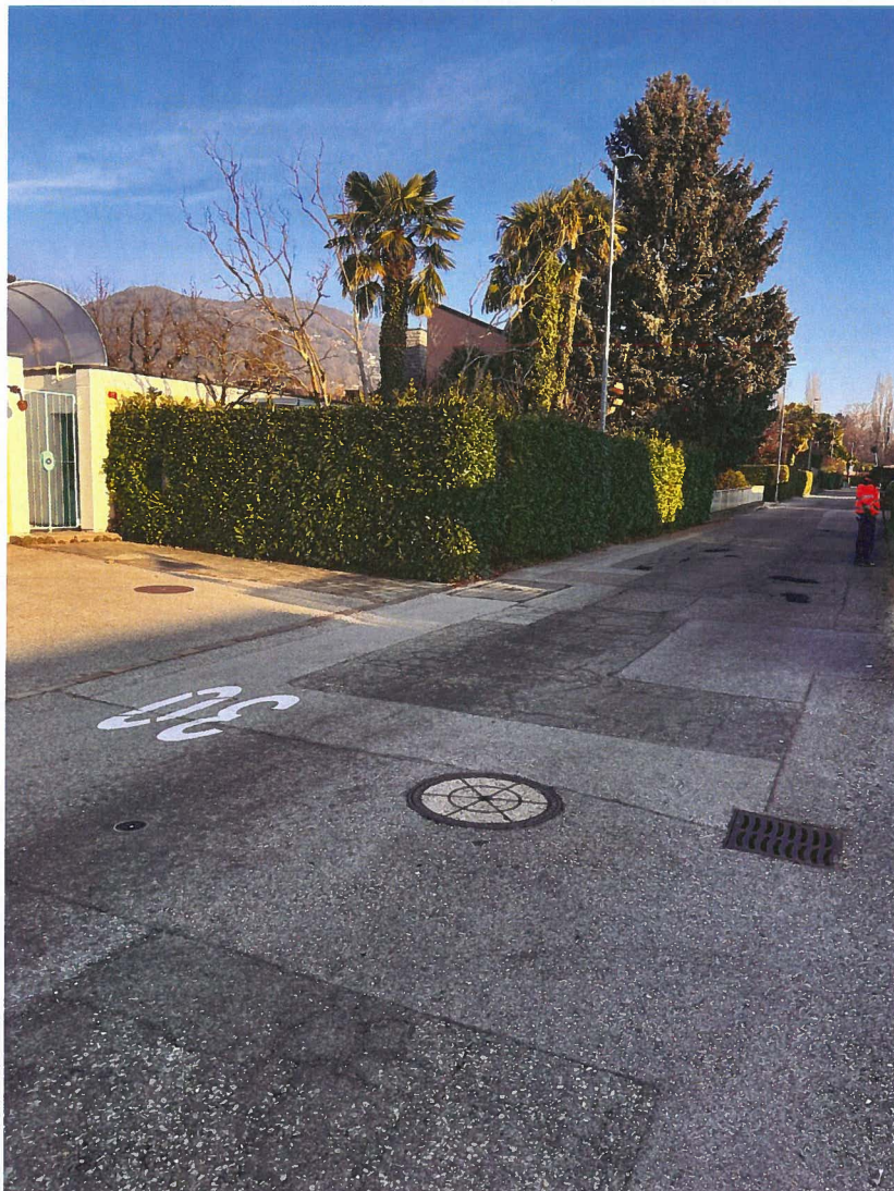
Figura 3 - Tratto stradale in prossimità dell'imbocco da via Stazione: individuazione di rappezzamenti.
